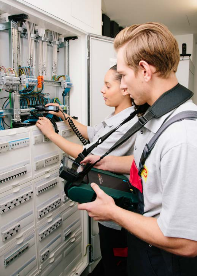
Die Elektrohandwerke kommen vergleichsweise gut durch die Krise.
